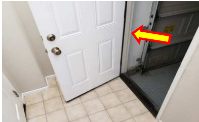
Fire door closer inoperable
