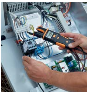
Medición de tensión en un compresor.
