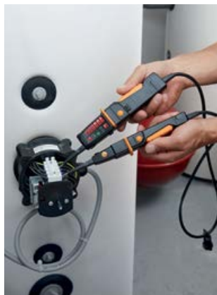
Medición de tensión en un acumulador térmico.
