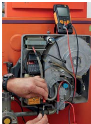
Medición de µA para comprobar la corriente de ionización.
