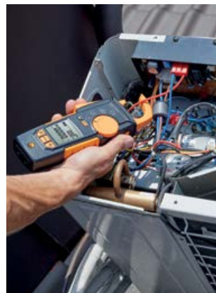
Medición de corriente en un compresor.
