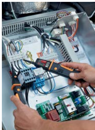
Medición de tensión en un compresor.
