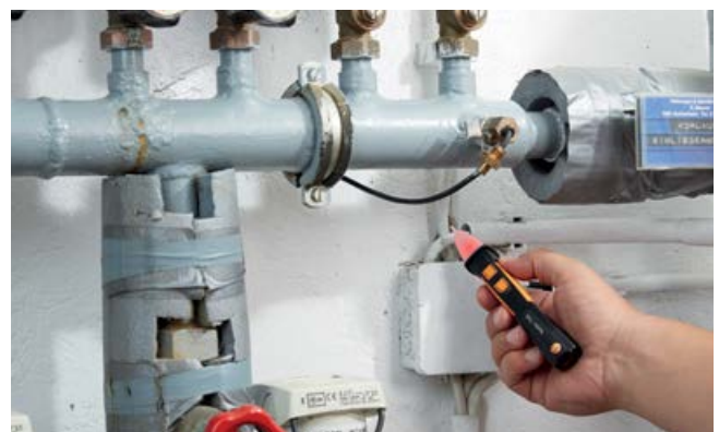
Comprobación de tensión en caja de conexiones eléctricas con testo 745 .
