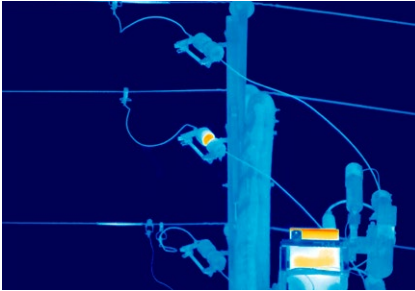
Daños del aislamiento en un poste de electricidad
