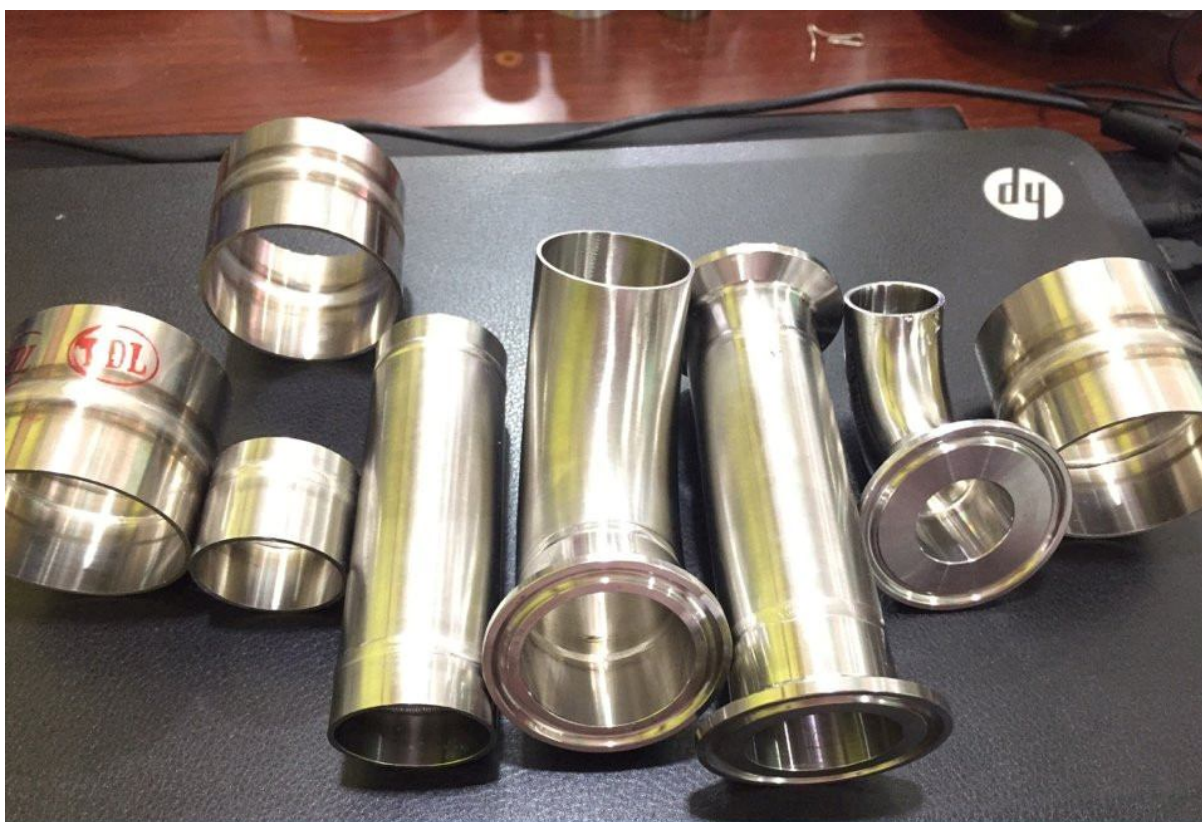
Kết quả hàn ống bằng đầu hàn kín Orbitec Hình chụp tại xưởng gia công hệ thống RO tại Bình Tân, TP HCM
