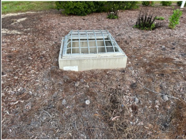
BMP3 Riser exterior
