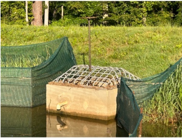
BMP1 Riser exterior
