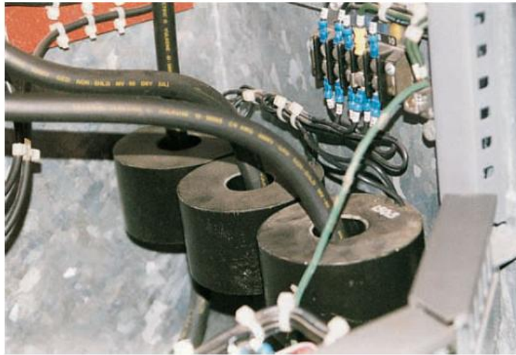
ပုံ ၄.၃၃ overload လျှပ်စီးများအား လျော့ချရာတွင် current transformer များ အသုံးပြုပုံ
