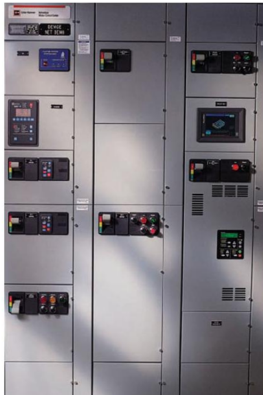
ပုံ ၅.၄၈ မော်တာ control center
