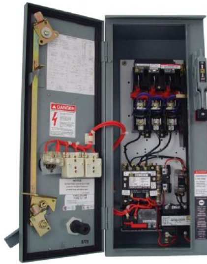
ပုံ ၅.၄၆ fuse disconnect ပါရှိသော combination starter တစ်ခု၊ control transformer၊ push-button များနှင့် မော်တာ starter
