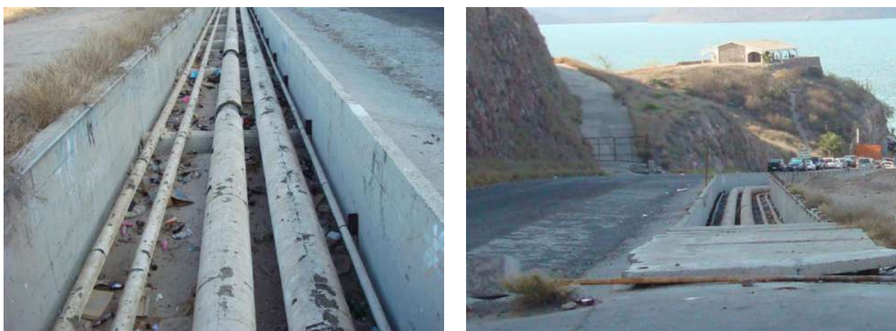
Figura 12 Corredor ductos de PEMEX a un costado del camino al muelle.
