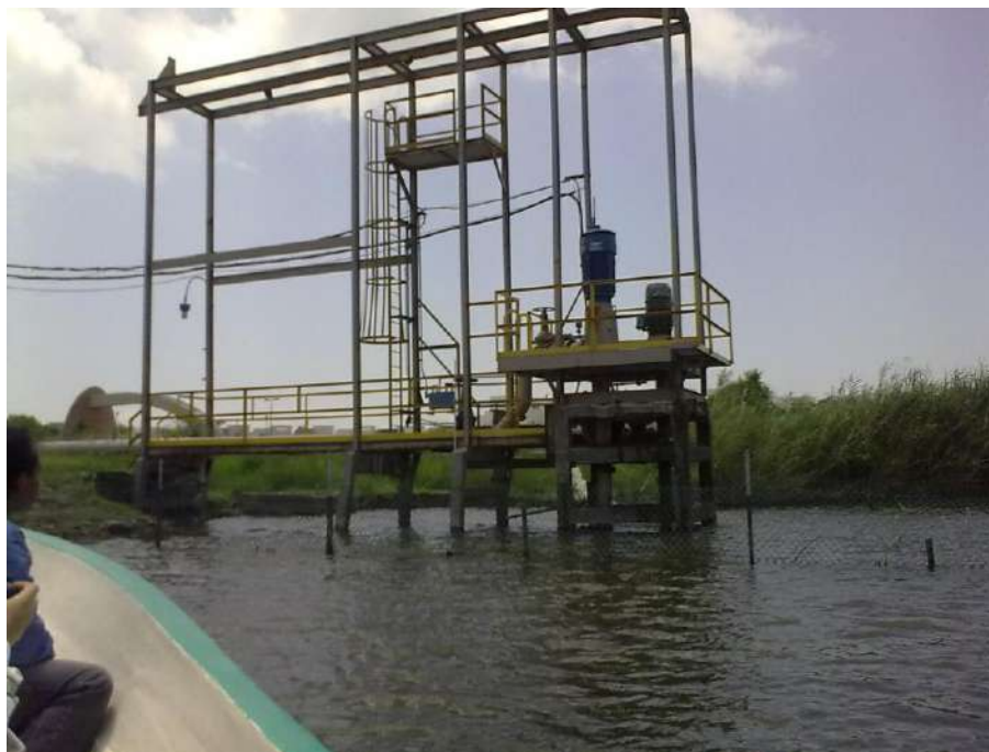
Figura 6 Ejemplo de una plataforma con equipo de bombeo.
