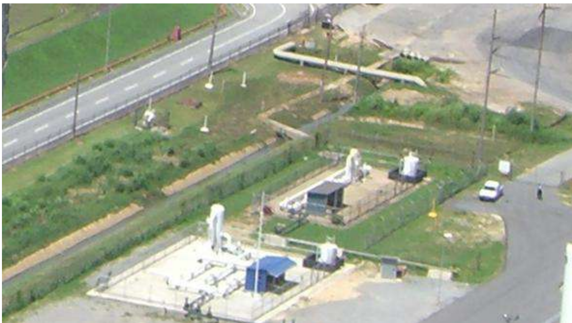
Ilustración 3 Ejemplo de estación de medición y regulación.
