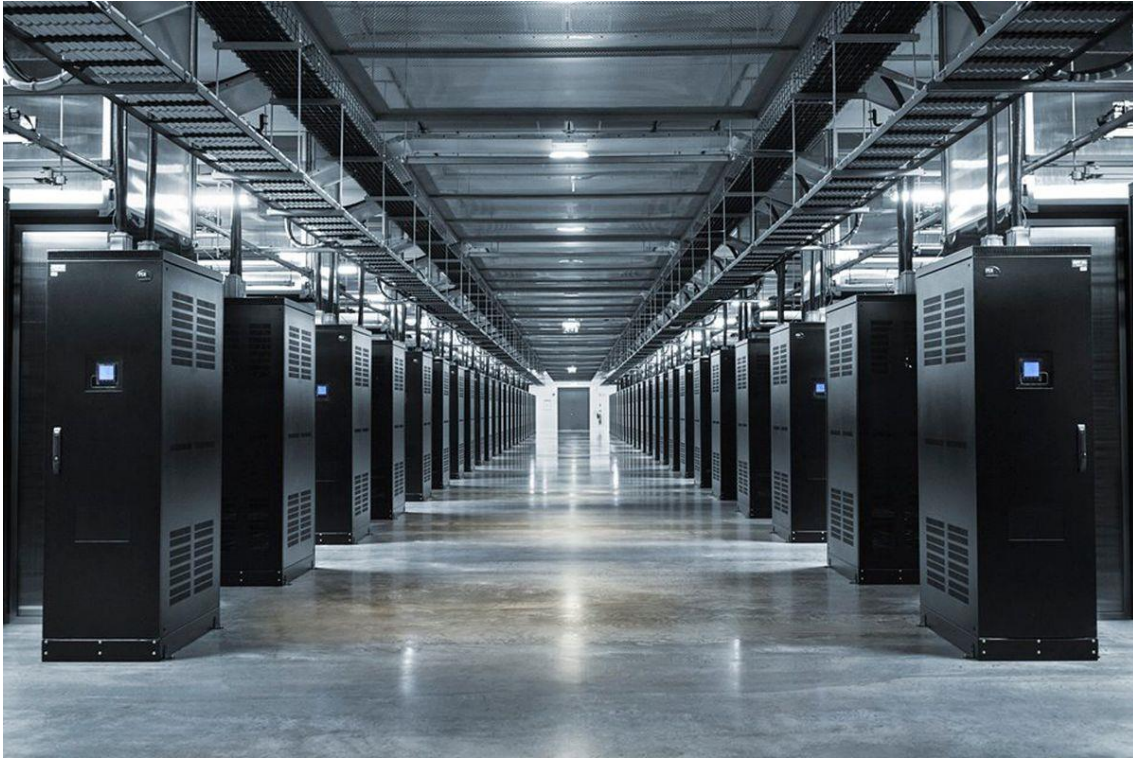
Figura 1.8 Sala de servidores para almacenamiento de datos
