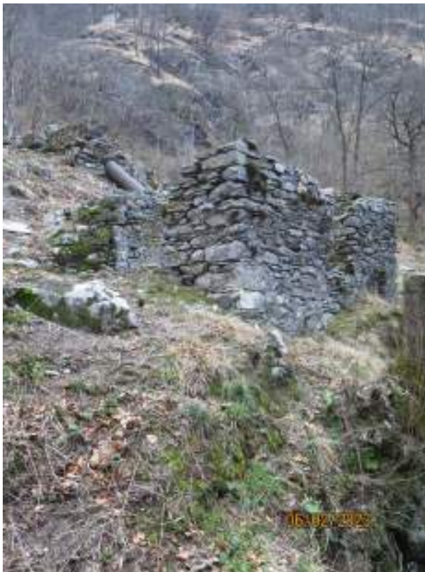
La discesa della condotta forzata verso la centralina
