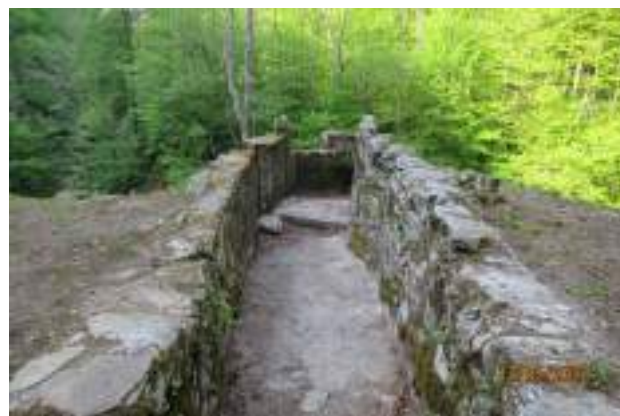
La fine del canale, prima della caduta nella centralina
