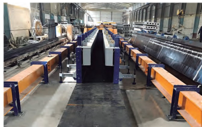
Pista universal y laterales con estructura auto-portante de acero
