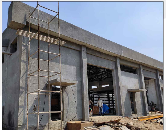
3000 MLD R.O. PLANT
