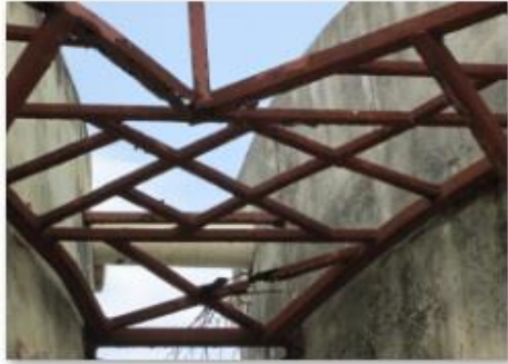
9. Deterioro de Plataformas
