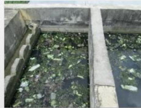
7. Estado inicial del Efluente en el reactor
