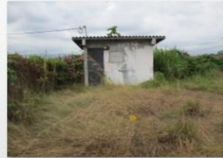
15 Estado inicial caseta de controles y vigilancia
