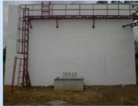
6. Estado final de reactores
