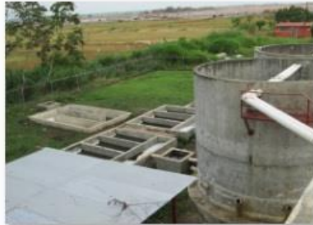
14. Biofiltros, Sedimentadores, cámara de
