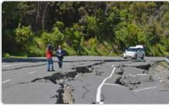
Görsel 3.25: Deprem sonucunda yolda meydana gelen hasar
