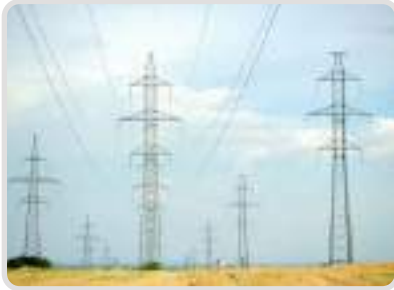
Görsel 1.17: Yüksek gerilim hattı
