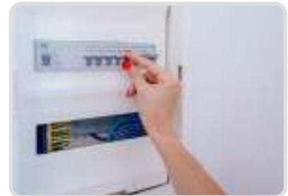
Görsel 1.12: Sigorta kullanılarak oluşturulmuş elektrik panosu
