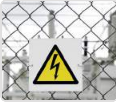
Görsel 1.9: Yüksek gerilim hattı uyarı levhası
