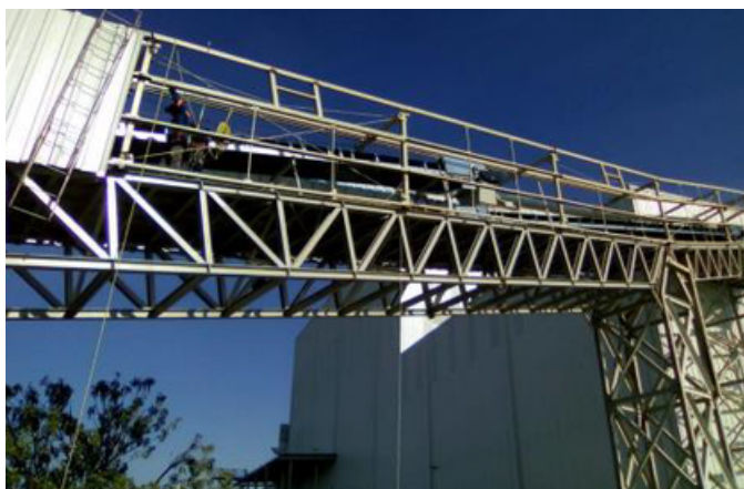
Plataforma para banda de Silos
