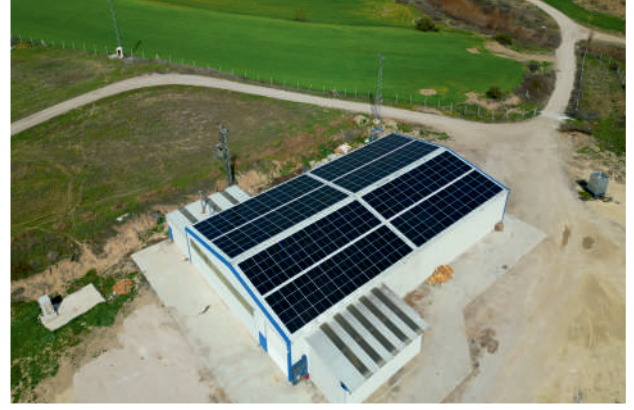
Tayftar Tarım GES / 1.85MW
