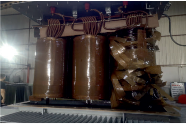
Yerinde Trafo Kontrolleri ve Yanık Trafo Tamiri
