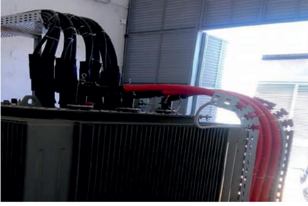
JNR 18MVA Trafo Tesisleri
