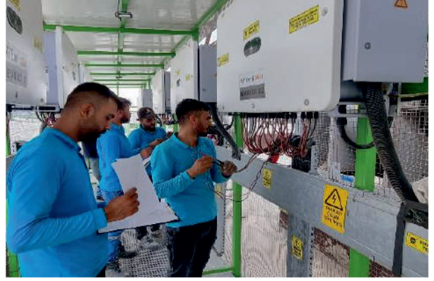
İnverter Test ve Ölçümleri
