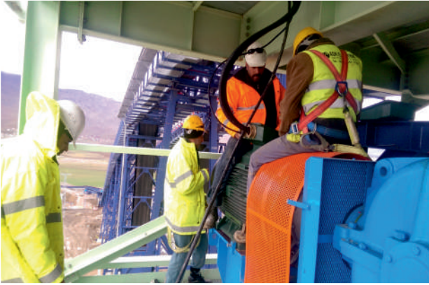
Bant Conveyor Motor Bağlantısı
