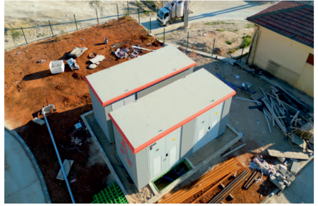
Green Enerji 1250kVA Trafo Tesisi
