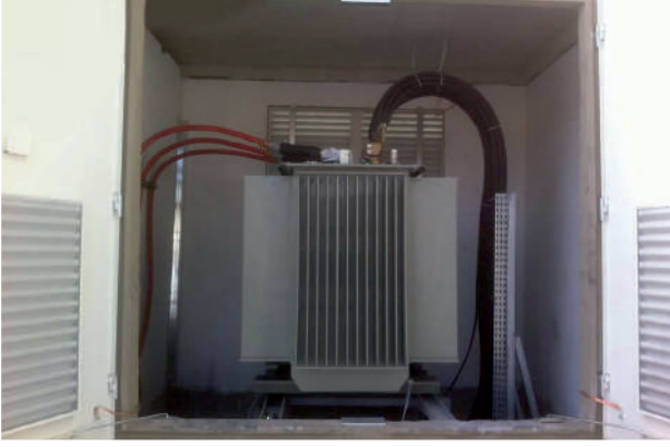
Emta 7MVA Trafo Tesisleri
