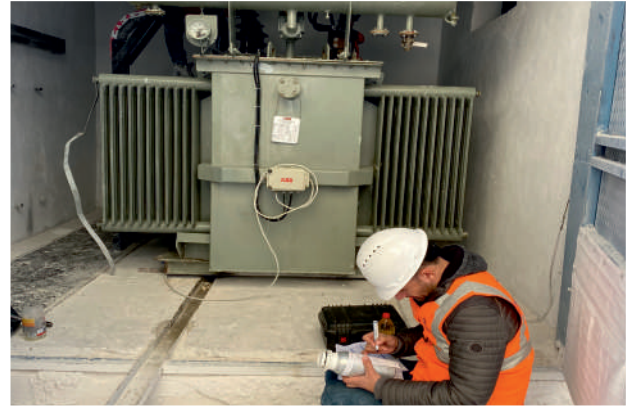
Trafo Yağ Analizi
