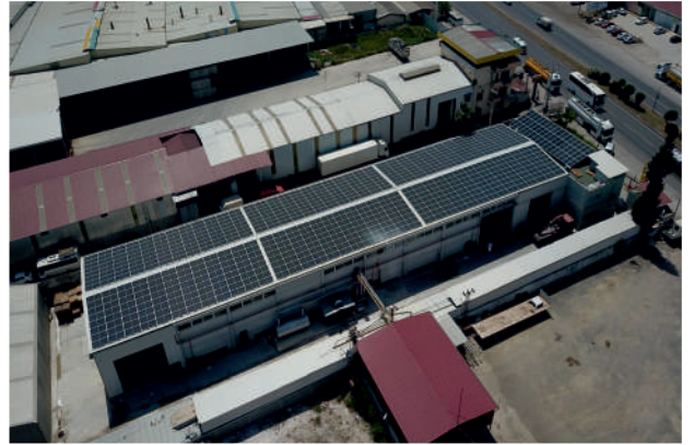
Serven SPP / 1,9MW
