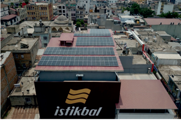
Yüksel 1 SPP / 900 kWp
