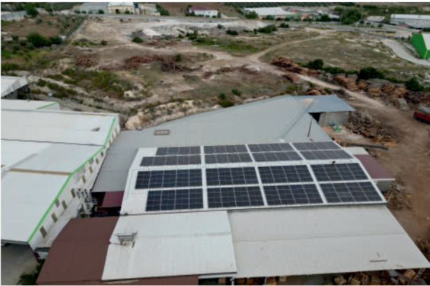
Dal Kereste SPP / 148,46kWp
