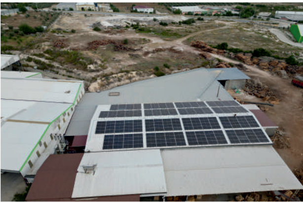
Dal Kereste SPP / 148,46kWp
