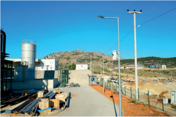
Green Enerji Kamera Sistemleri
