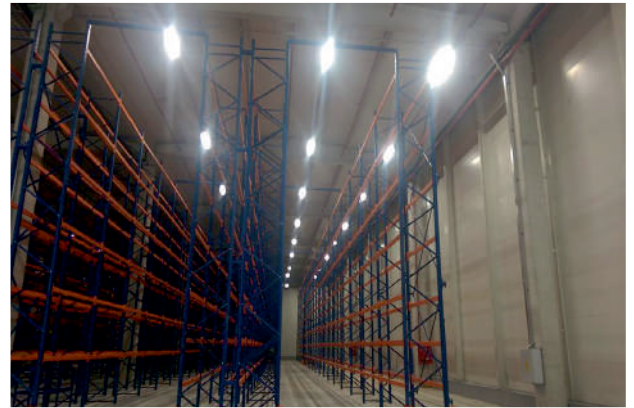
Reysaş İç Aydınlatma Sistemleri
