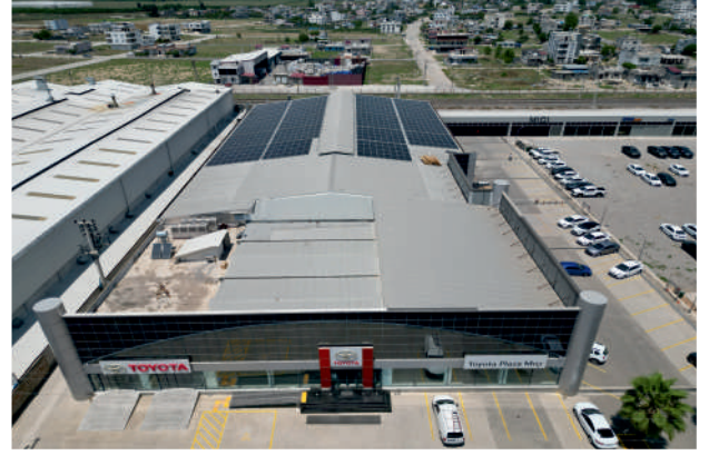
Toyota Plaza Mıçı GES / 388kWp
