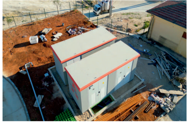
Green Enerji 1250kVA Trafo Tesisi
