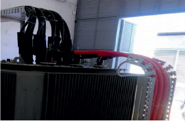
JNR 18MVA Trafo Tesisleri
