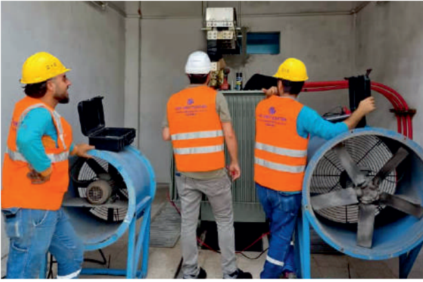
Trafo Sargı Direnci ve Megger İzolasyon Tesi
