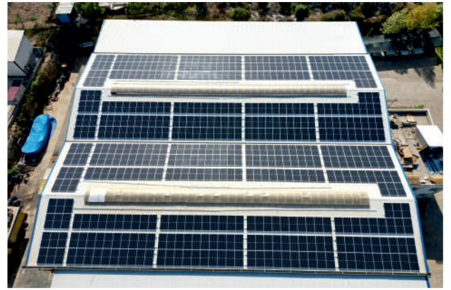
Nika GES / 240,24kWp
