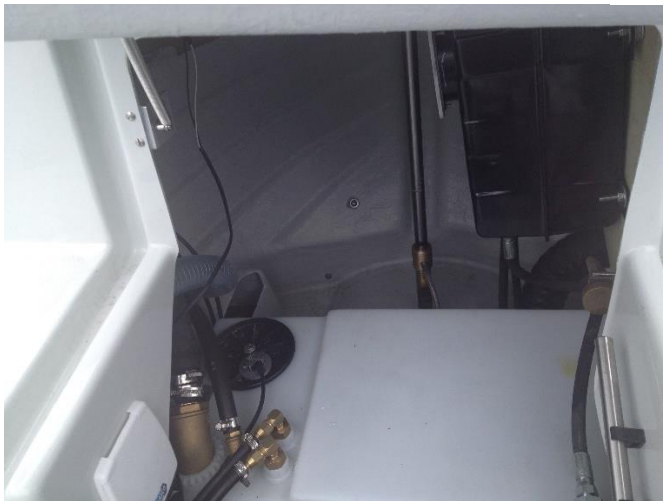
Fast tank med enkel tillgång till förfilter (diesel) samt hjärtstock
