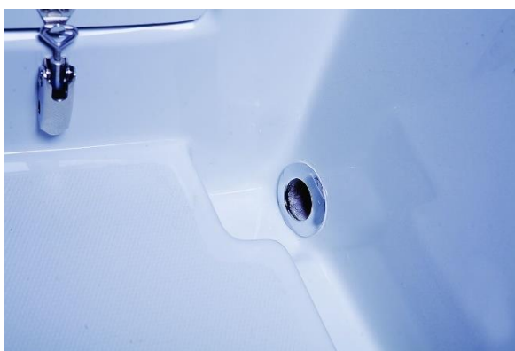
I sittbrunnen finns 2 st självlänsar med kran.
