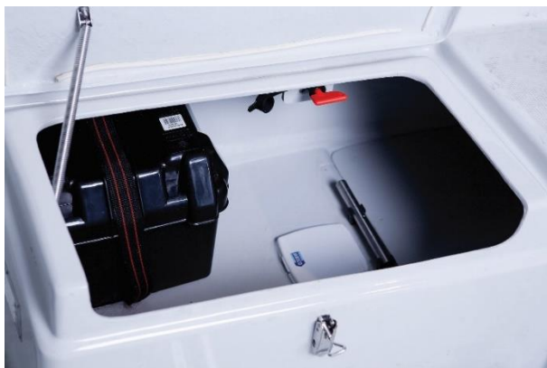
Batterilåda med huvudströmbrytare och plats för eldsläckare
