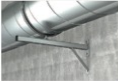
Hava Kanalı ve Boru Konsolları
