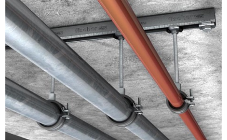
Isıtma Soğutma ve Sıhhi Tesisat Boruları
