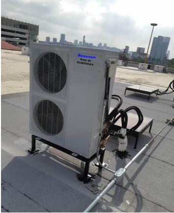
Unidad exterior condensadora
