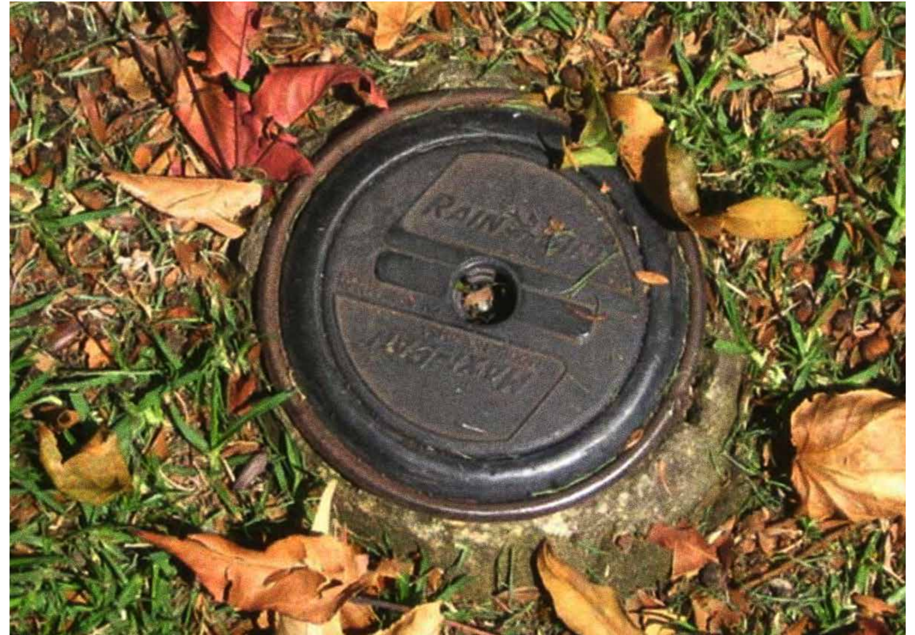
Sistema de riego inoperante
