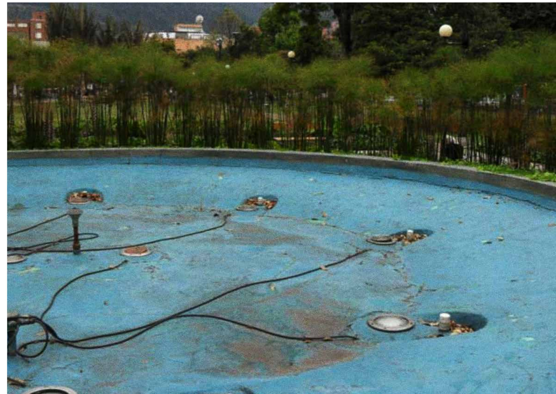
Fuente de agua sin funcionar
