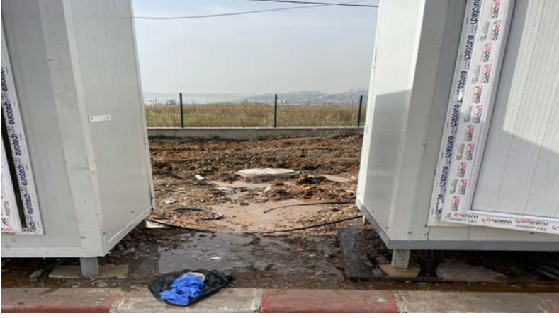
Fotoğraf 5. Bağlantı Noktalarından Su Sızdıran Kabin Tuvaletler
