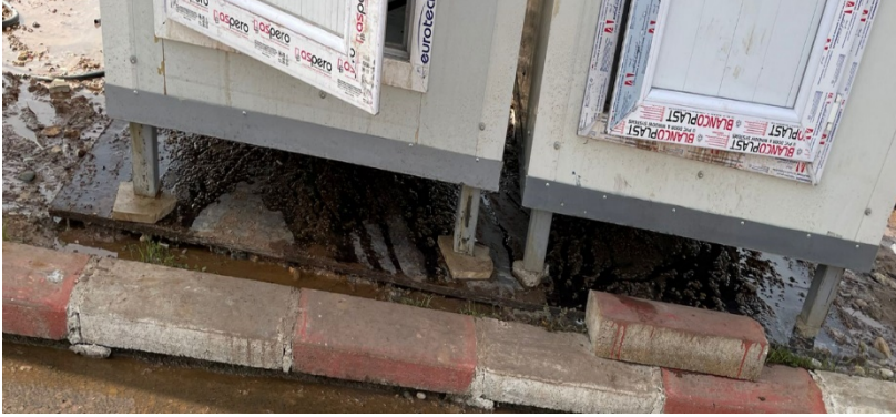
Fotoğraf 6. Bağlantı Noktalarından Su Sızdıran Kabin Tuvaletler
