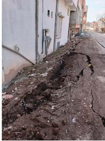
Şekil 1 Gölbaşı (Adıyaman) İlçesindeki Bir Binada Sıvılaşmadan Dolayı Meydana Gelen Oturma Durumu
