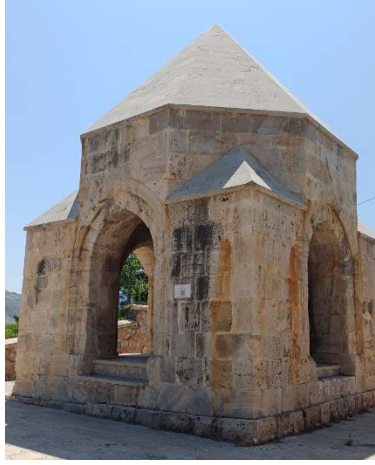
Şekil 2. Erenler Türbesi mevcut durumu (Yazarın arşivinden).
