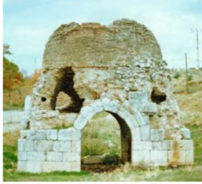
Şekil 3. Erenler Türbesi restorasyon öncesi durumu (Tokat Vakıflar Bölge Müdürlüğü; Kalınbayrak Ercan & Kalkan Açıkkapı, 2022)
