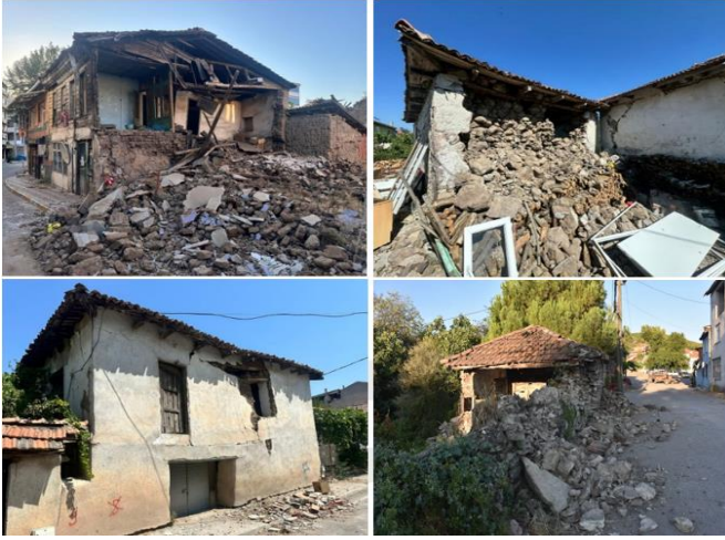
Şekil 5.3. Geleneksel yığma yapılarda oluşan hasarlar
