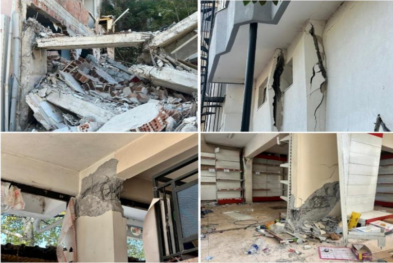
Şekil 5.1. Betonarme yapılarda gözlemlenen genel hasarlar.
