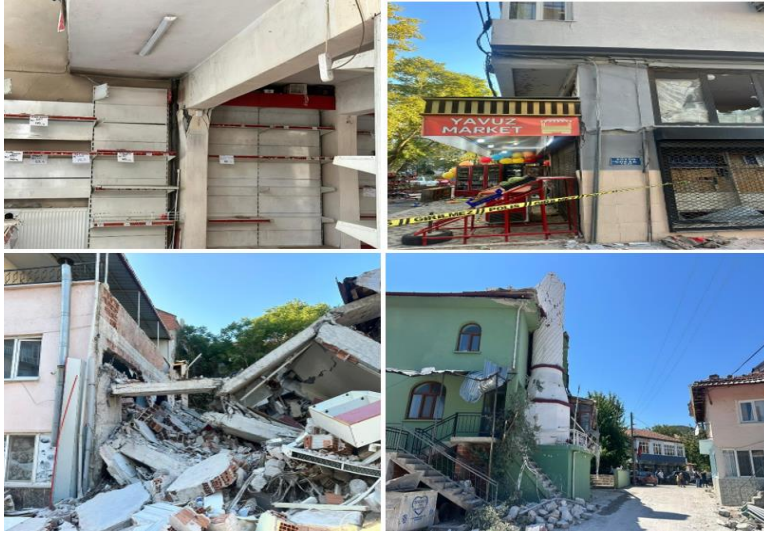
Şekil 5.2. Betonarme yapılarda gözlemlenen yumuşak/zayıf kat ve çekilme etkisi hasarları.
