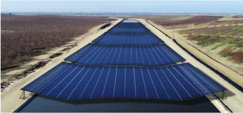
Fig. 4 Canal-top solar PV system ( Solar AquaGrid)
