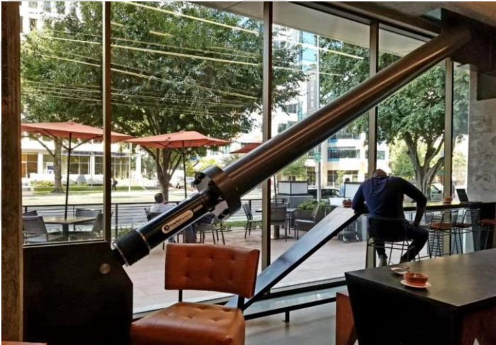
Şekil 2. Viskoz sıvı sönümleyici uygulaması
