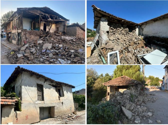
Şekil 5.3. Geleneksel yığma yapılarda oluşan hasarlar
