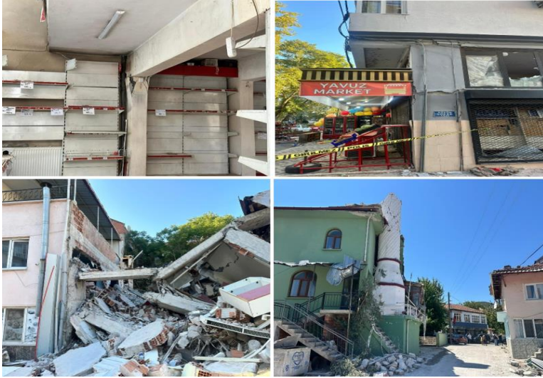
Şekil 5.2. Betonarme yapılarda gözlemlenen yumuşak/zayıf kat ve çekiçleme etkisi hasarları.
