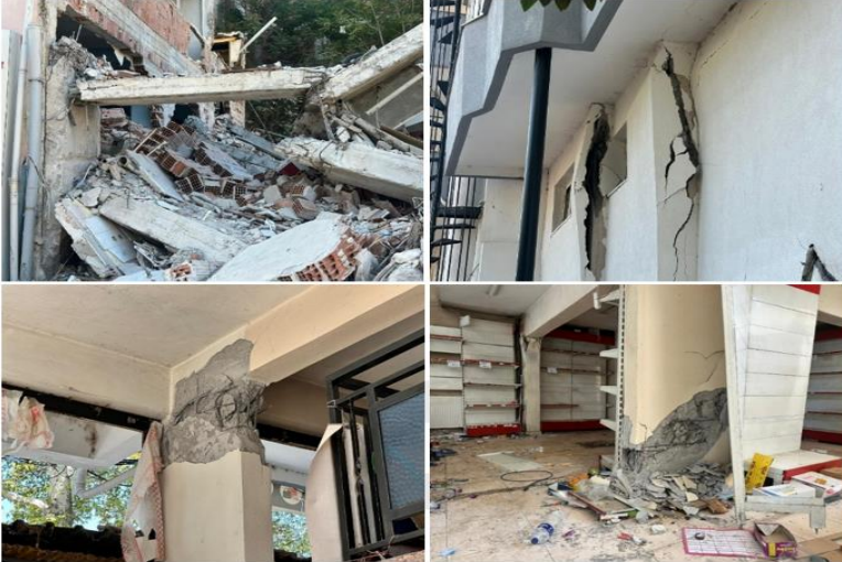
Şekil 5.1. Betonarme yapılarda gözlemlenen genel hasarlar.
