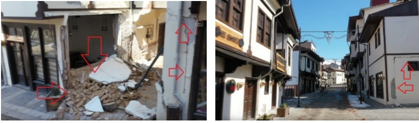
Şekil 5. Yeşilyurt Konaklarında Görülen Kerpiç Duvarlarda Yıkılma ve Çatlama Örnekleri (yazar arşivi, 2023).
