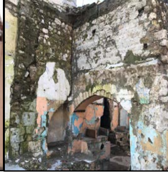
Görsel 5. Beyseri H. Deprem Sonrası Soyunmalık Bölümü Ön Kısım
