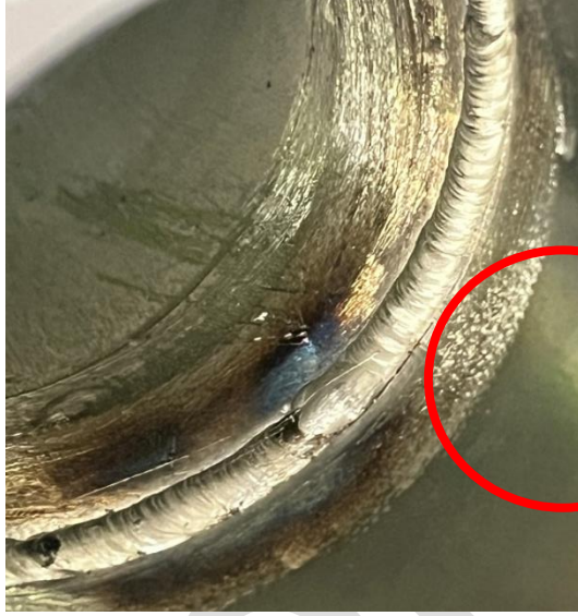
Şekil 3. Görsel muayene sırasında tespit edilen kök kaynağında ki ergime noksanlığı.
