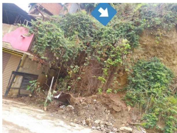
Deslizamiento Carretera vieja, Caracas – La Guaira, 4 casas en peligro
