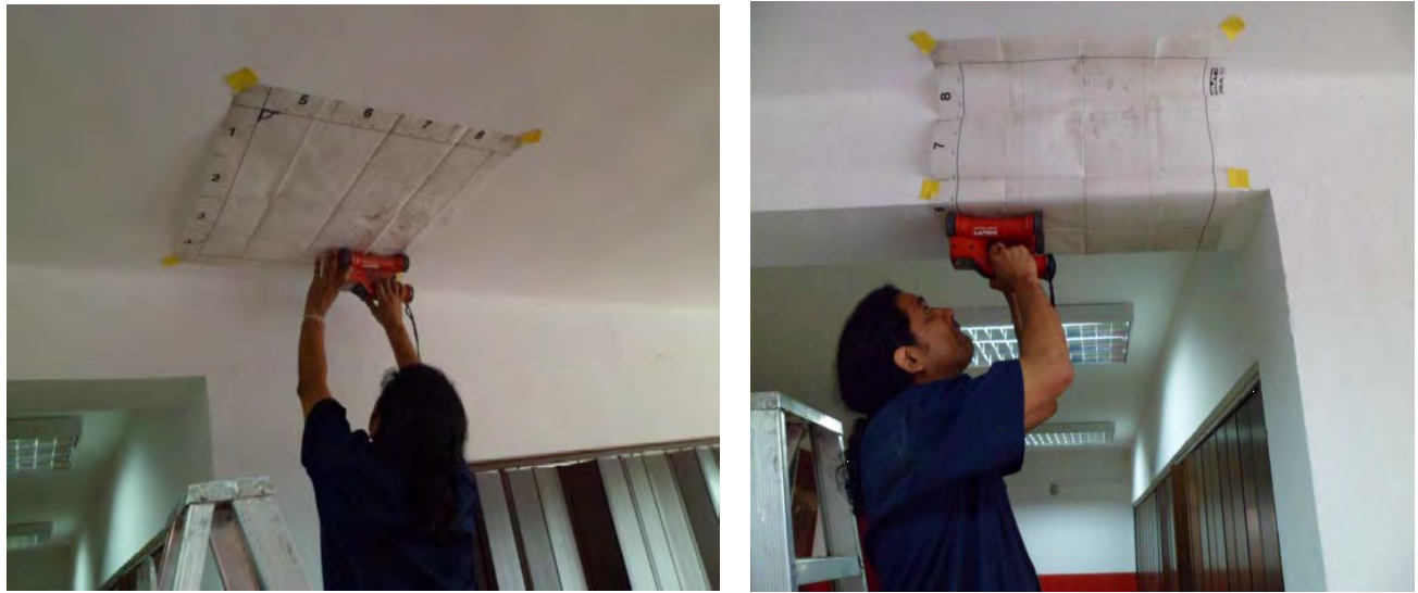
Comprobación de la ausencia de vigas planas en sentido longitudinal a la izquierda, a la derecha, verificación del acero de refuerzo en las vigas.
