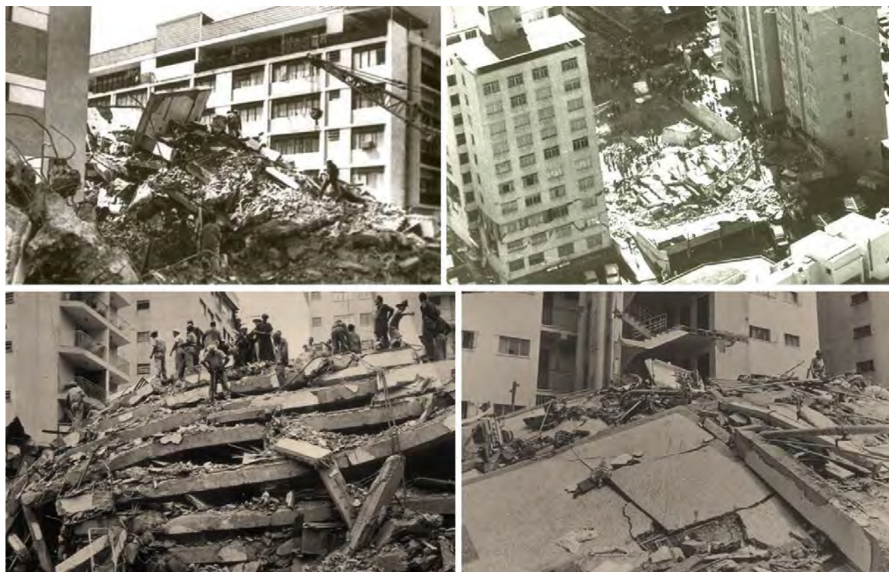
Edificios colapsados: Neverí, San José (Hanson & Degenkolb, 1969) Mijagual (Valois, 1967) y Palace Corvin (Steinbrugge, 1967)
