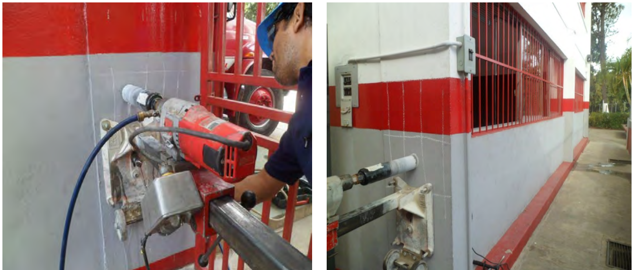
Figura 13.8. Toma de núcleos de concreto en dos columnas de la estructura, a la izquierda en el módulo de doble altura y a la derecha en el de servicios.
