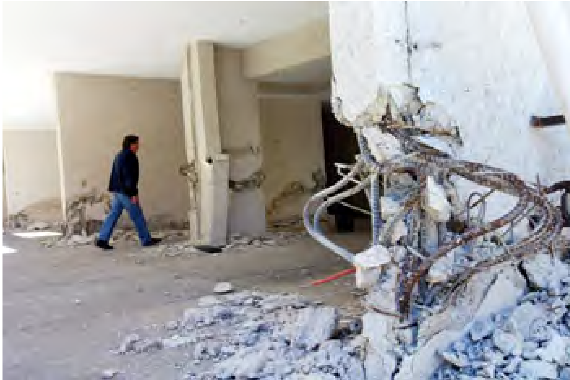
Figura 9.2 Daños en muros del edificio Toledo en Viña del Mar (El Mercurio, 2010).
