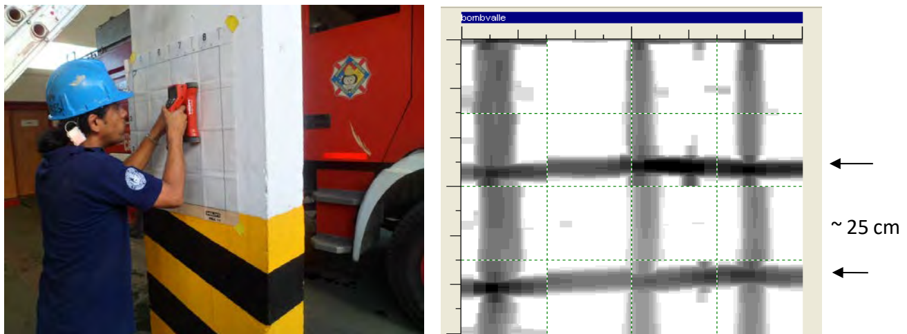
Verificación del refuerzo longitudinal y transversal (estribos) en el tramo central de la columna del módulo de doble altura. Se indica la separación aproximada.
