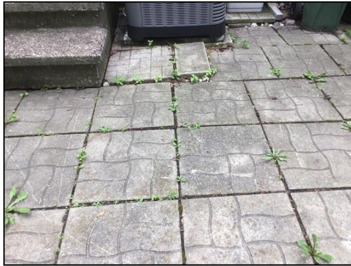
9. Uneven (trip hazard)
