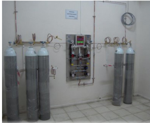
Resim 33- Merkezi Oksijen ve Azotprotoksit Santrali
