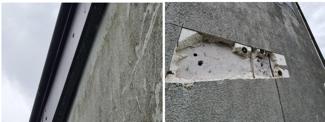
Figuur 6: Geen ruimte tussen muur en trespa gootbetimmering (links). Proefopening op de begane grond toont de ontoegankelijke spouw (rechts)
