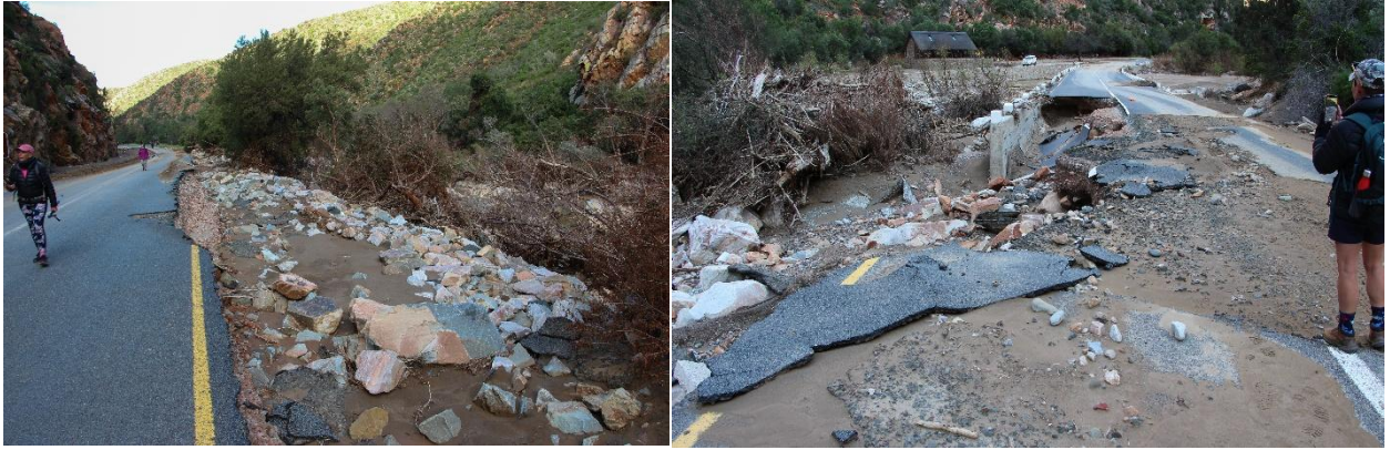
Skade langs die pad en op die pad.
