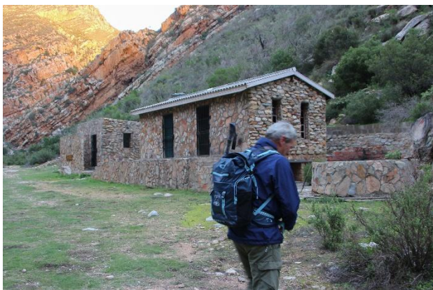
Die gevandaliseerde voetslaanhut
