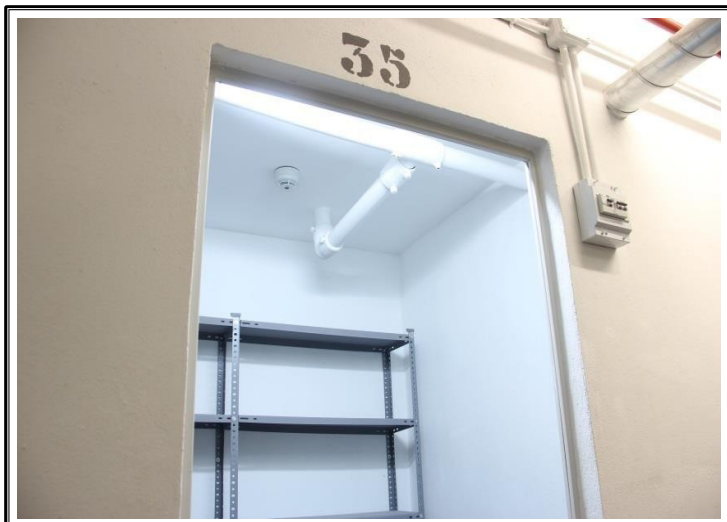
Vista exterior sub-entidad y medidor de luz independiente
