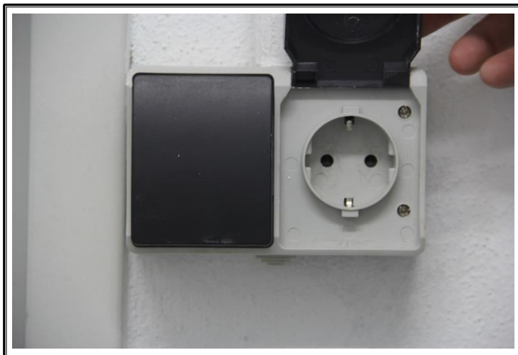
Enchufe e interruptor (interior sub-entidad)
