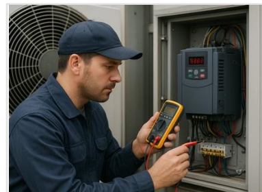
Control y Eléctrico HVAC
