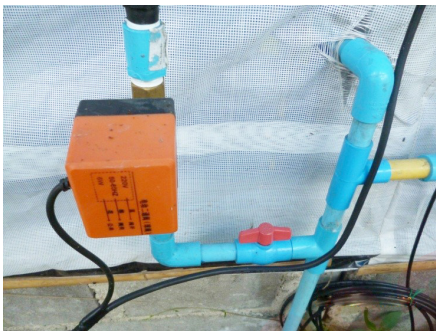
△ วาล์วเปิด-ปิดน้ำ
