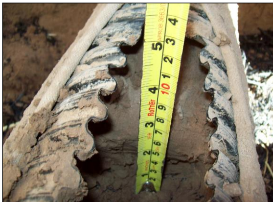
Figura 8. Estado de la tubería de drenaje subterráneo de la parcela 36 Ejido Oaxaca
