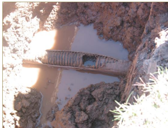
Figura 9. Dren parcelario en el Lote 45-47 Módulo de Riego No. 15.
