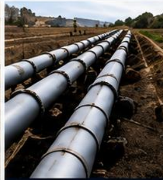
ROTURAS DE TUBERÍAS
