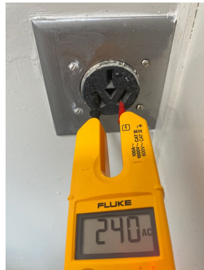
220 volt outlet present
