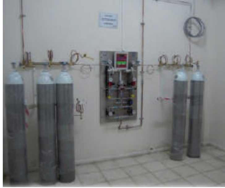
Merkezi Oksijen ve Azotoksit Santrali
