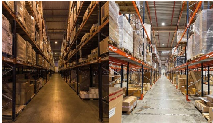
Ilustración 4 Comparación visual de un entorno industrial antes y después de la sustitución de luminarias tradicionales por sistemas LED, evidenciando mejoras en uniformidad y calidad de la iluminación. Navigant Consulting. (2019). Energy savings forecast of solid-state lighting in general illumination applications. U.S. Department of Energy.
