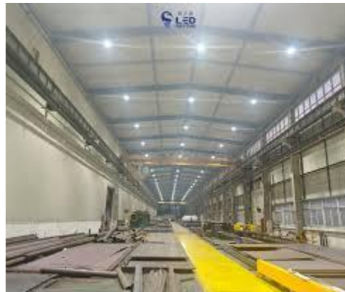
Ilustración 3 Sistema de iluminación LED tipo campana (high bay) instalado en una nave industrial, diseñado para proporcionar alta intensidad lumínica en espacios amplios con techos elevados. International Energy Agency. (2023). Lighting.
