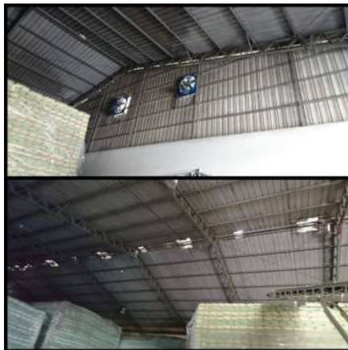
Figura 2.5 Bodega 4 - Ventiladores ubicados en las paredes e inyectores de aire ubicados en la parte mas alta de la bodega.
